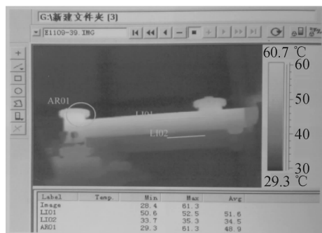
图 16 某 110 kV 变电站 GIS XXI 回隔离开关过热红外图谱
